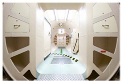
Gösgen I (2012) Kernkraftwerk Gösgen, Personenschleuse 3/7 80 x 120 cm 2'400
